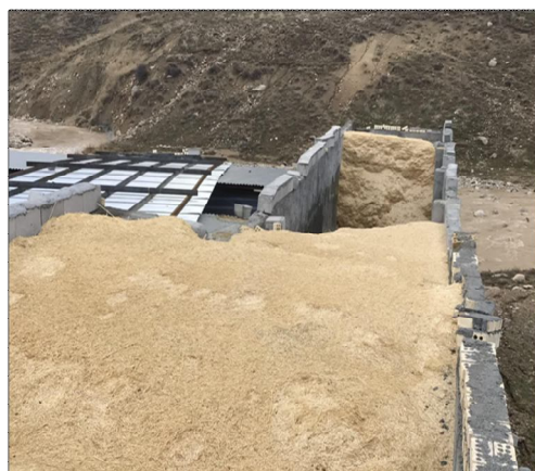
شکل 13- تخریب انبار علوفه و تلف شدن ذخیره علوفه‌ای
