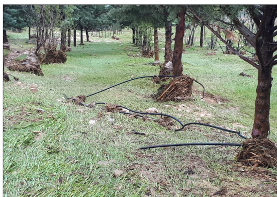
شکل 16- تخریب شبکه لوله‌های سیستم آبیاری قطره‌ای
