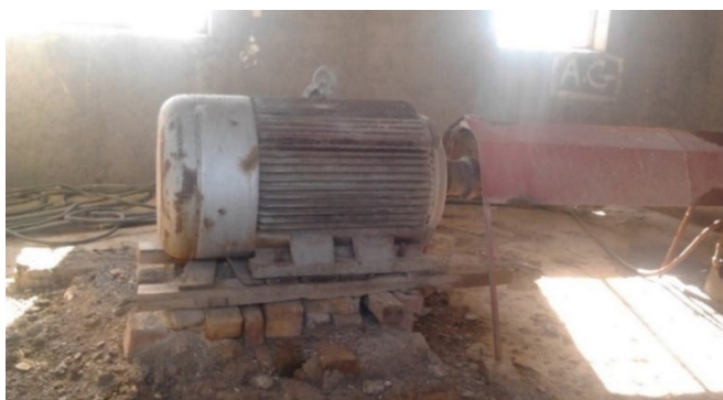
شکل 1- نمونه‌ای از شیوه بهره‌برداری اشتباه و نصب نامناسب الکتروموتور در ایستگاه پمپاژ (یوسف گمرکچی، 1395)
