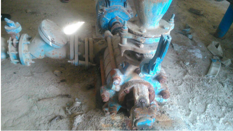
شکل 3- نمونه‌ای از شیوه نادرست نصب پمپ (یوسف گمرکچی، 1395)
