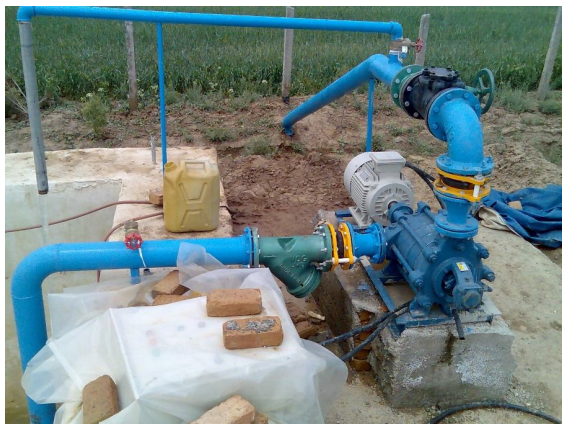
شکل 22- نمونه‌ای از عدم ایجاد مکان سرپوشیده و سکو سازی نامناسب برای پمپ و الکتروموتور (یوسف گمرکچی، 1396)
